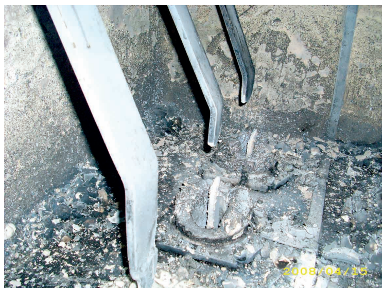
Fot. 3.2. Skutki zwarcia w polu rozdzielczym w KWK „Sośnica-Makoszowy”
