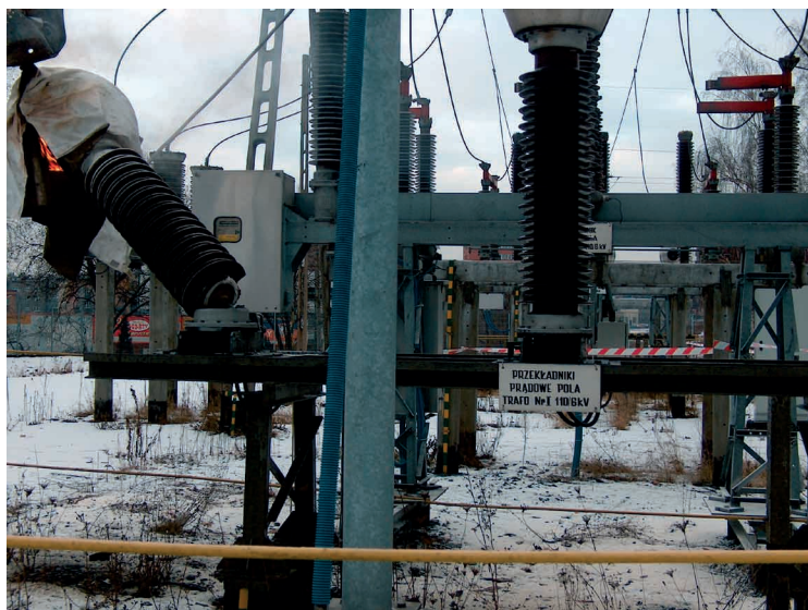
Fot. 3.1. KWK „Pokój” – uszkodzenie przekładnika prądowego
