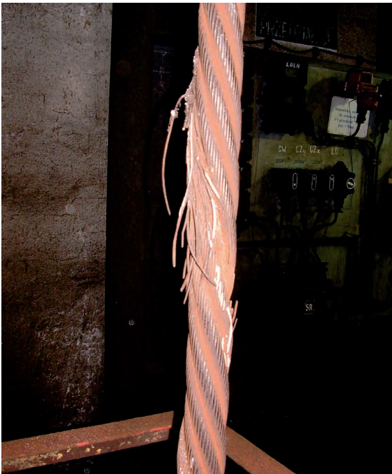
Fot. 3.3. Uszkodzenie liny nośnej będące powodem zatrzymania wyciągu szybowego w KWK „Bielszowice”
